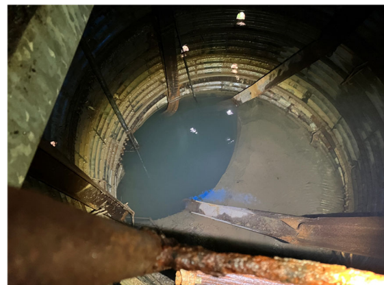
写真 2 集水井内部のせん断破壊状況
